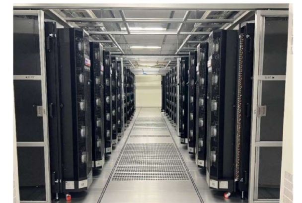
図4-3.NTTデータ三鷹ビルEAST リアドア空調方式によるコロケーションサービスエリア
